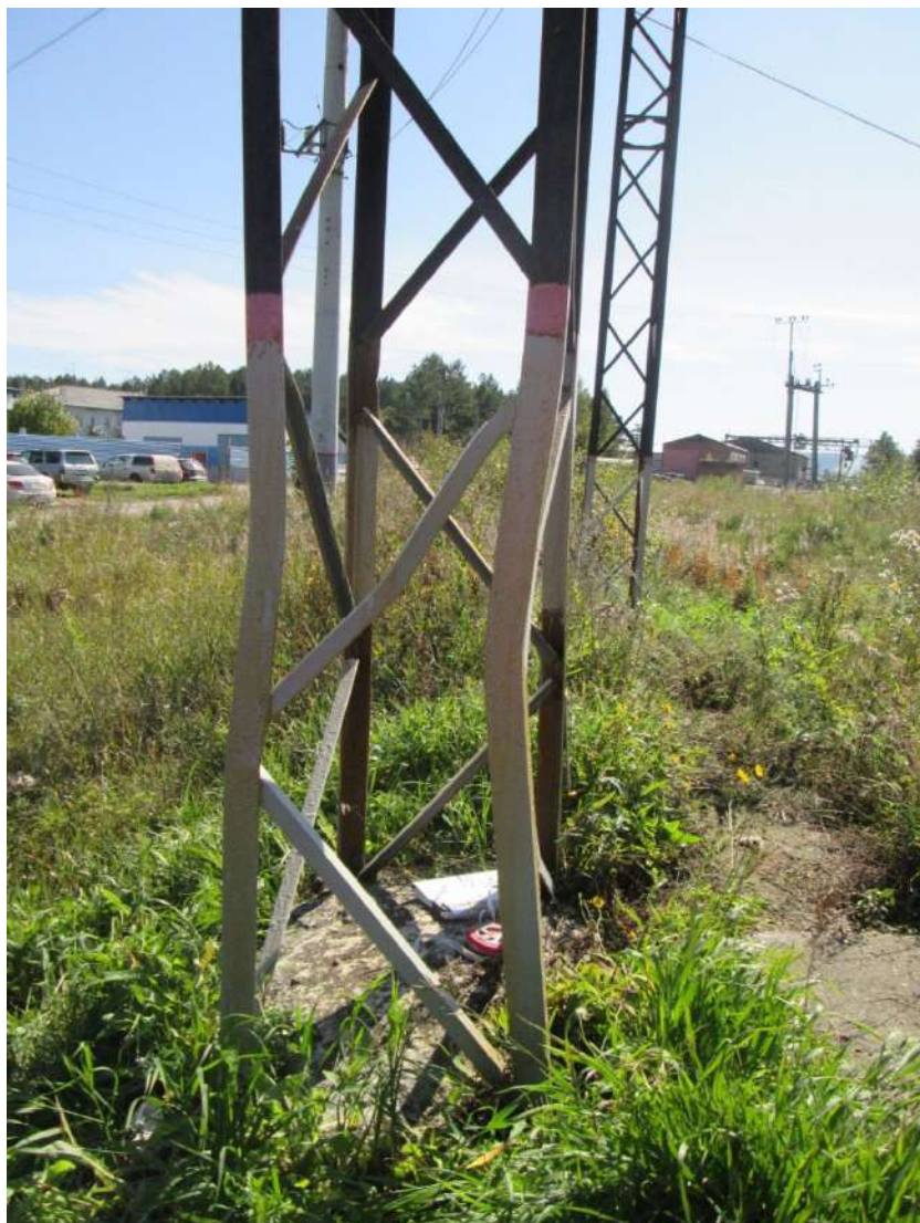
Рисунок 2 – Повреждение в виде погнутоści силового уголка и раскоса металлической опоры
